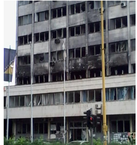
Das ausgebrannte Regierungsgebäude in Tuzla
